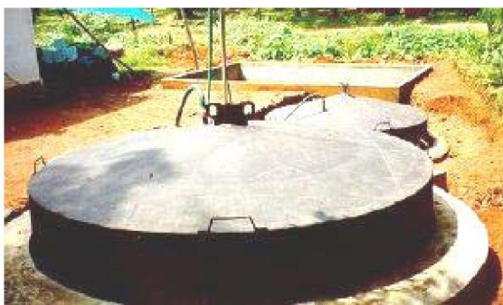
Рис.23. Простейшая биогазовая установка (Тайвань)
