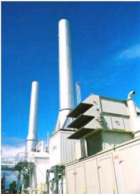
Рис. 38. Общий вид когенераторной электростанции
