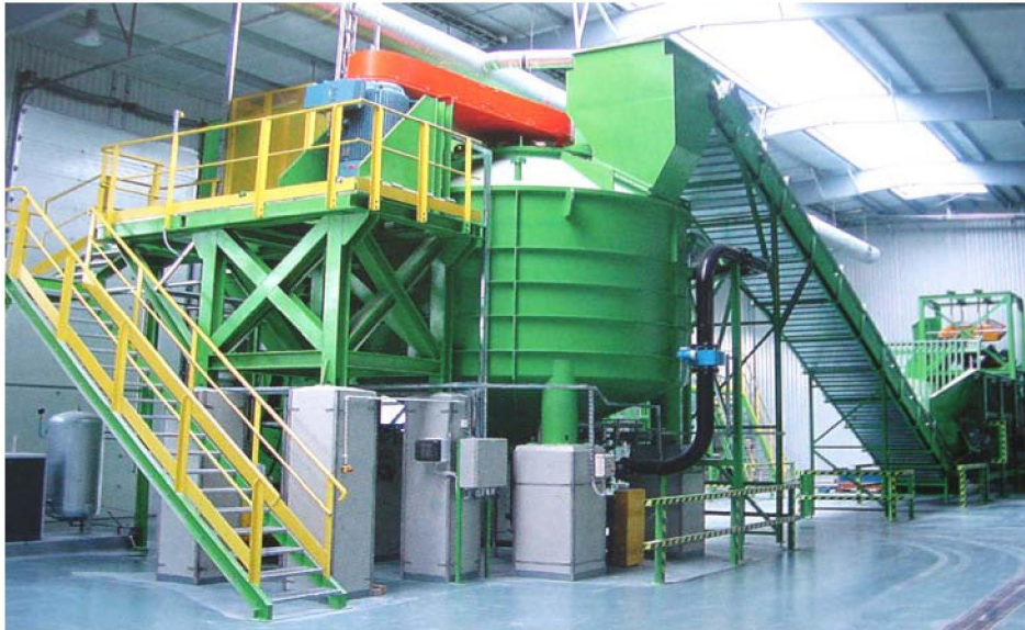
Рис. 51. Линия гидромеханической переработки отходов
