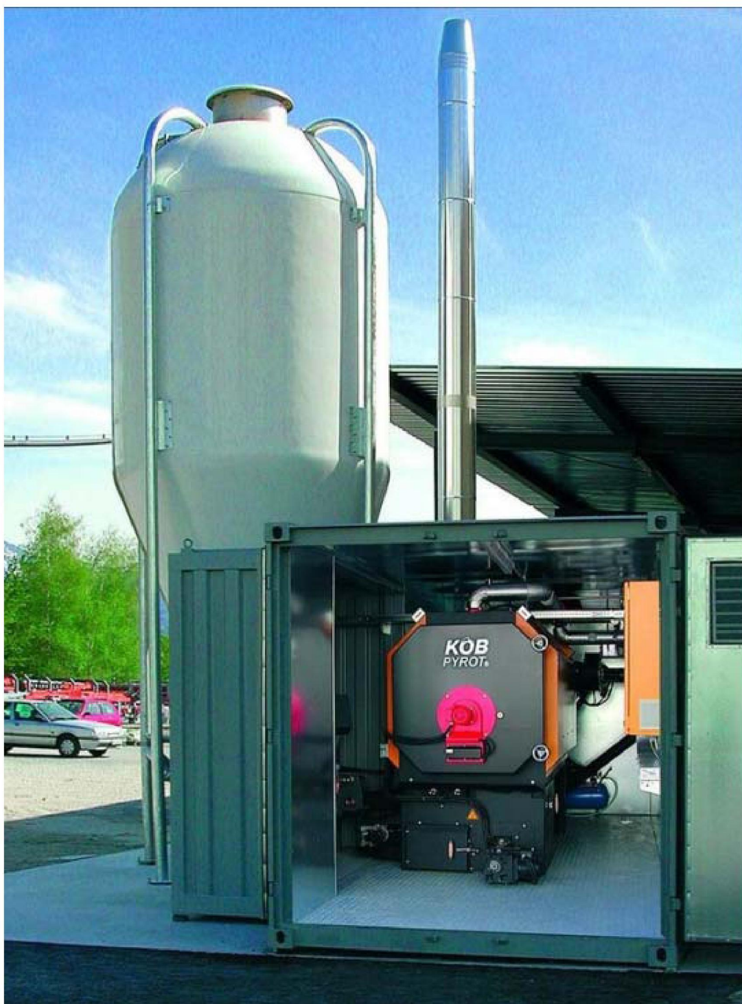
Рис. П 3.11. Теплоэнергетическая установка мощностью 300 кВт фирмы КОВ (Австрия), использующая в качестве топлива пеллеты
