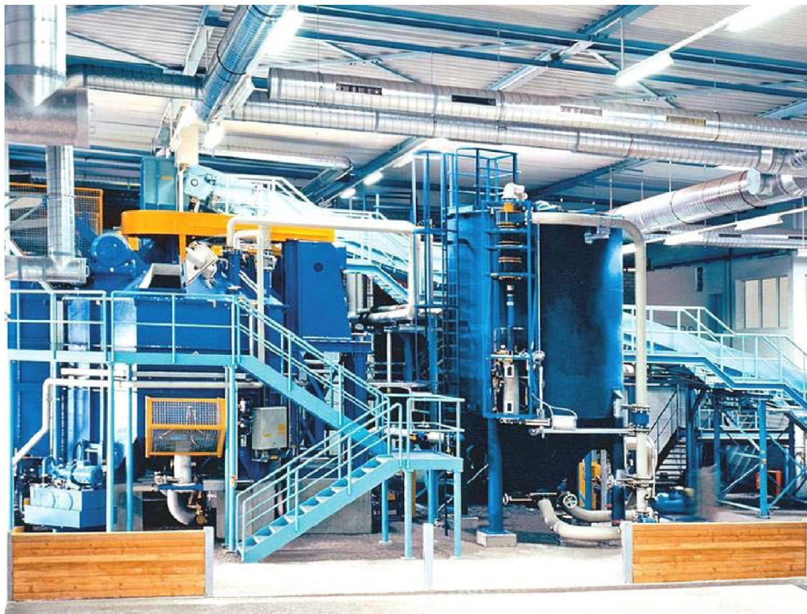
Рис. П4.1. Технологический участок гидромеханической переработки отходов (компания «ВТА International GmbH», Германия)
